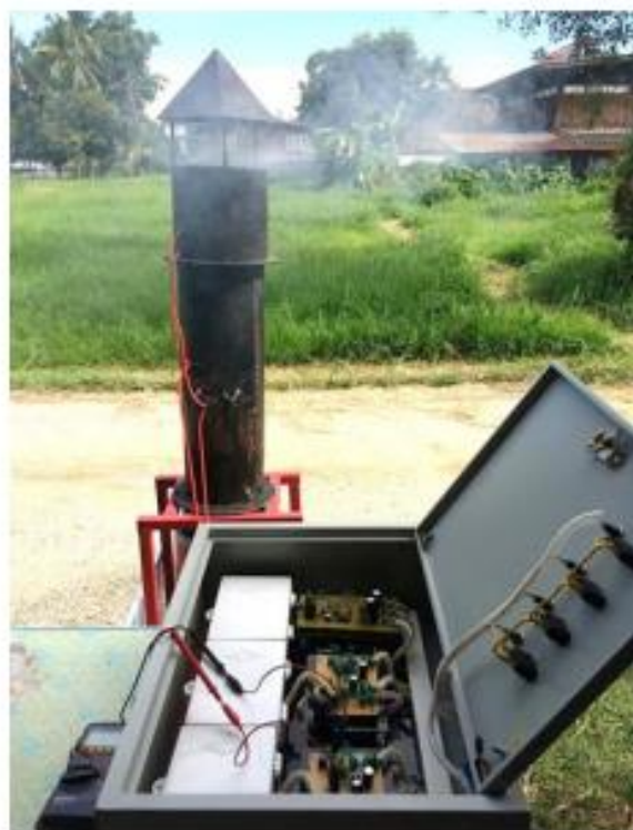
แหล่งจ่ายไฟฟ้าแรงดันสูงและ เครื่องตัดกั้นควมโรงบับไวยาสูบ
